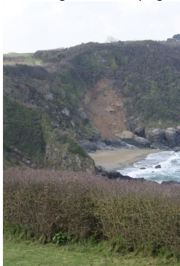
Affaissement de falaise à Tréveneuc Crédit photos : B. Josse - S. Treps – syndicat mixte du Pays de Saint-Brieuc
