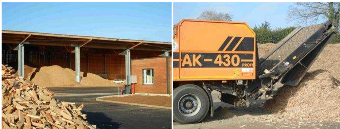
Figure 7 : Plateforme bois énergie de Nozay et machine de criblage (Sources BEMA)
